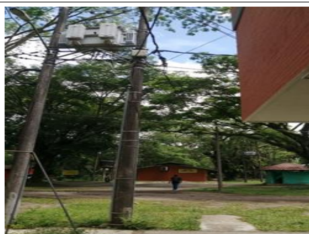
Foto No: 4 Observaciones Particulares: transformador de 112,5kVA
