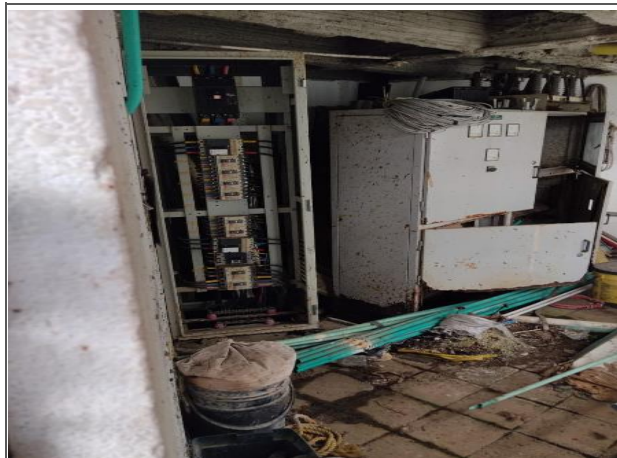
Foto No: 3 Observaciones Particulares: tablero de distribucion TD-TR08
